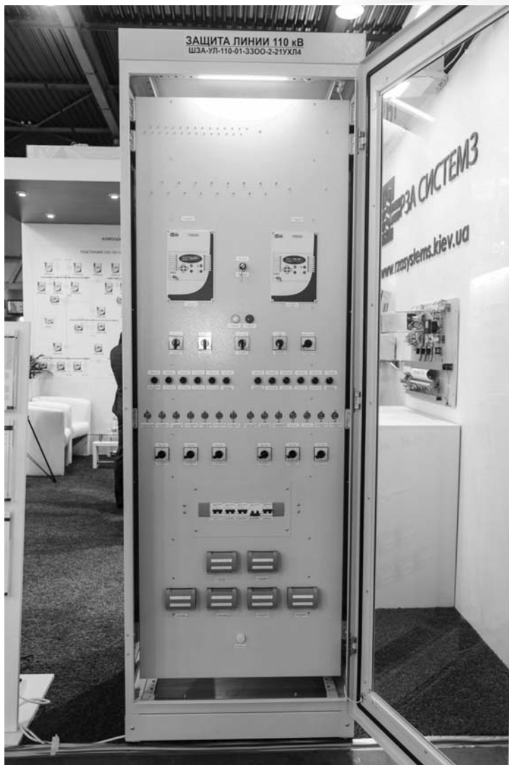
Рис. 2. Вид на шкаф ШЗА-110 со стороны фасада
