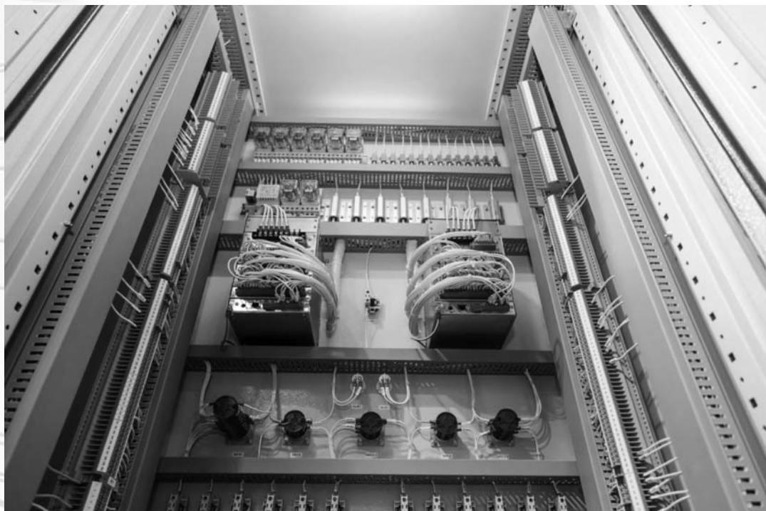
Рис. 3. Вид на внутреннее устройство шкафа ШЗА-110
